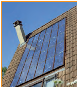
Le capteur photovoltaïque produit de l'électricité.
