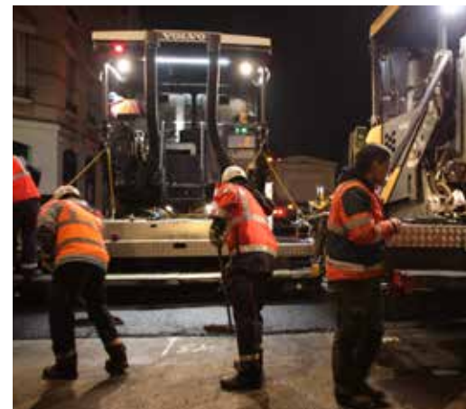
↑ Au fur et à mesure de la pose du bitume, les ouvriers assurent les finitions, notamment le contour des bouches d'égout. Un travail d'orfèvre qui se poursuivra jusqu'au petit matin.
