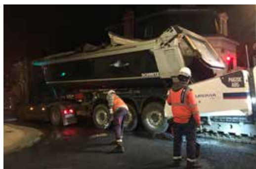
↑ Les camions se calent contre les finisseurs, engins mobiles destinés à appliquer les enrobés pour y déverser le bitume.
