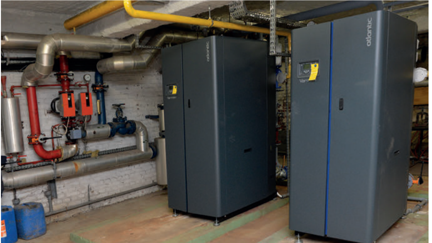
De nouvelles chaudières à condensation équipent à présent le groupe scolaire Gambetta.
